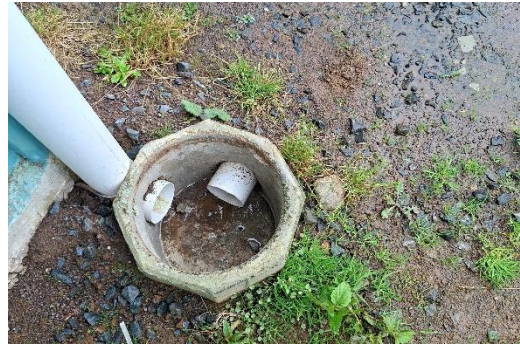
Caja de registro pluvial sin tapa
