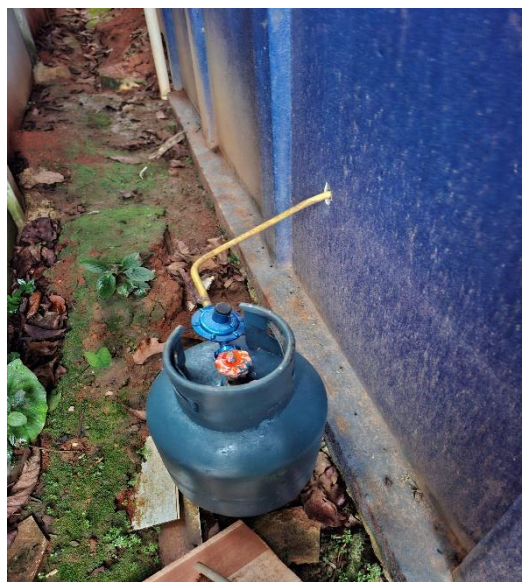
Tanques de gas ubicados en el exterior de la vivienda
