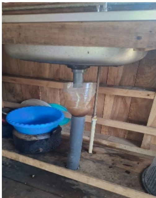
Fregadero sin llave de control ni sifón
