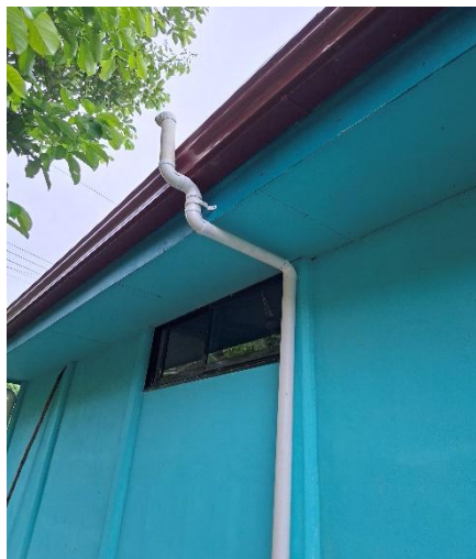
Ventilación de sistema sanitario
