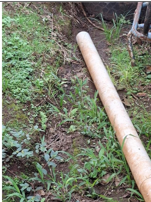
Aguas residuales evacuan en propiedad
