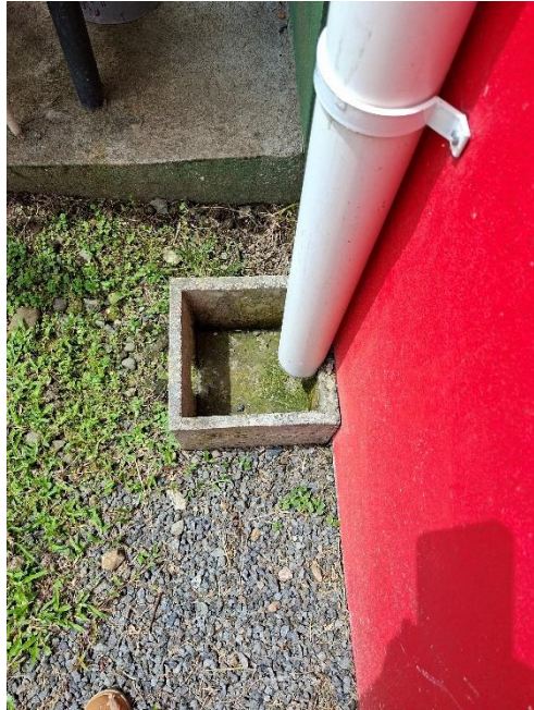
Caja de registro pluvial sin tapa
