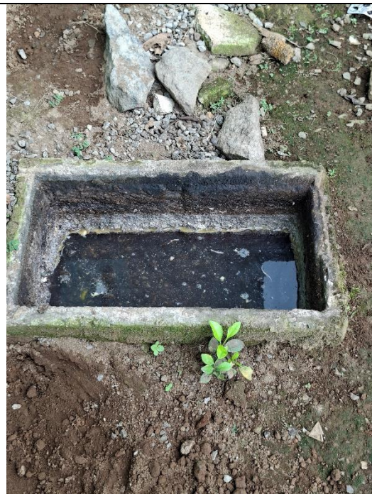
Caja de registro de aguas residuales sin tapa
