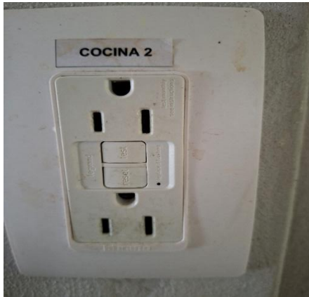
Tomacorriente con protección GFCI
