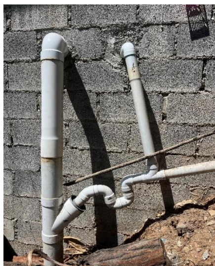
Tubería de aguas residuales
