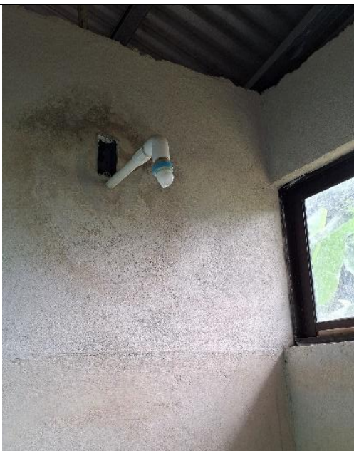
Cuarto de baño sin aspersor.
