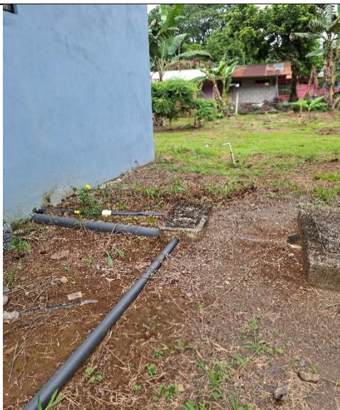
Tubería de aguas residuales expuesta
