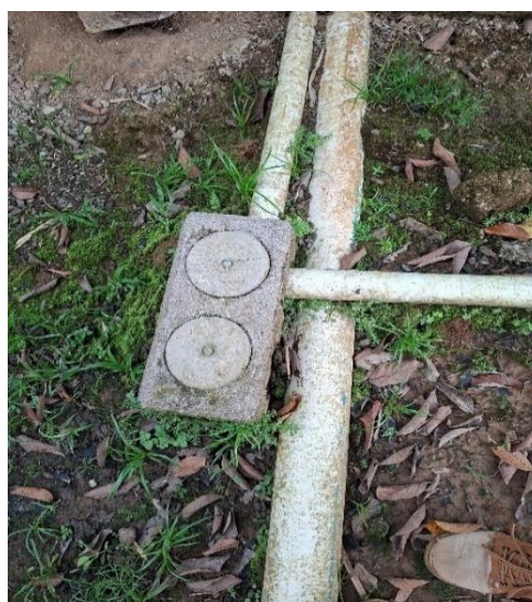
Tubería de aguas residuales expuesta y caja de registro superficial
