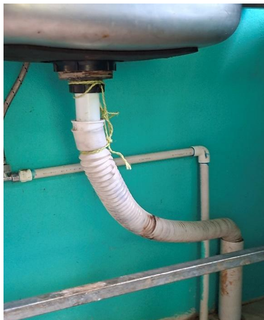
Sifón de manguera no funcional
