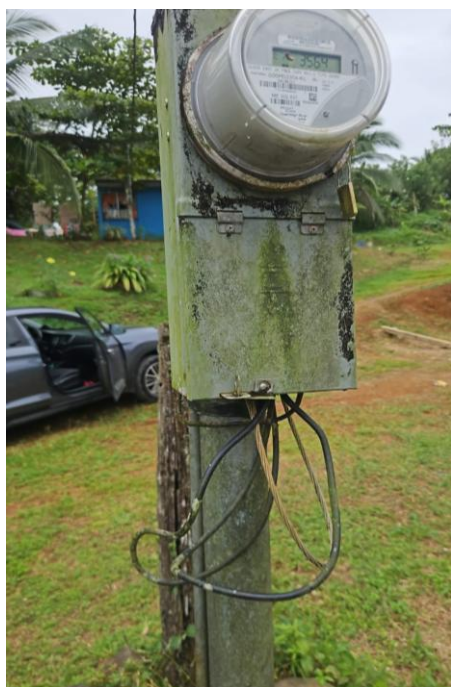
Base de medidor no sustituida
