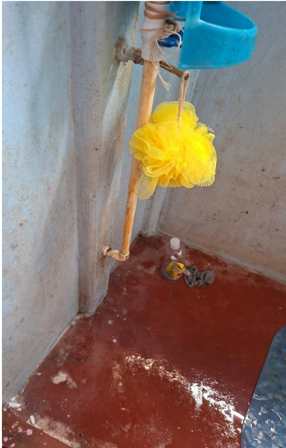
Paredes sin impermeabilizar
