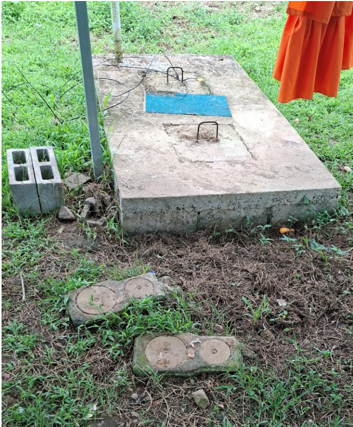
Registro y tanque séptico
