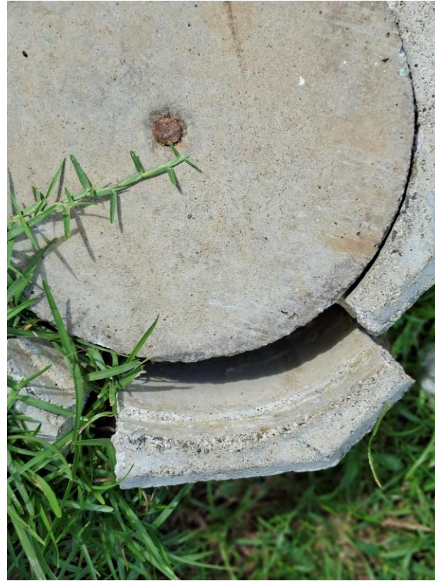
Caja de registro quebrada
