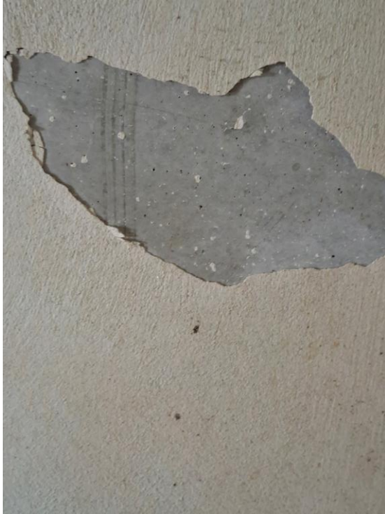
Desprendimiento de repello
