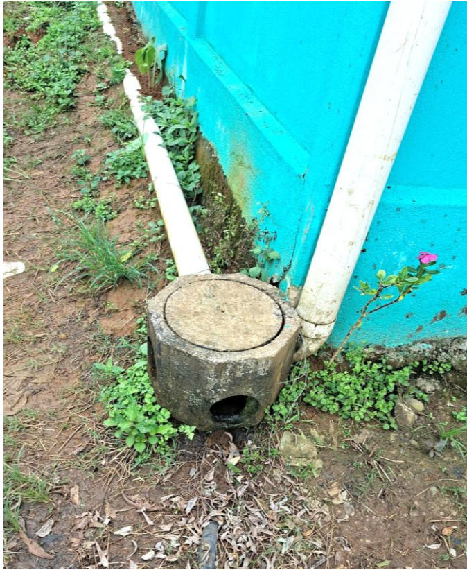
Caja de registro sin enterrar
