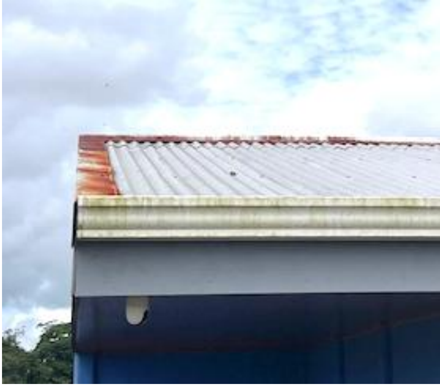
Nivel de corrosión muy avanzado en un techo nuevo.
