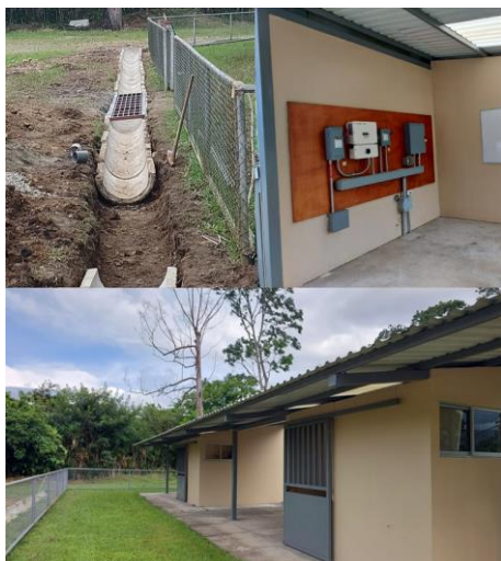
Área de Paneles Solares
