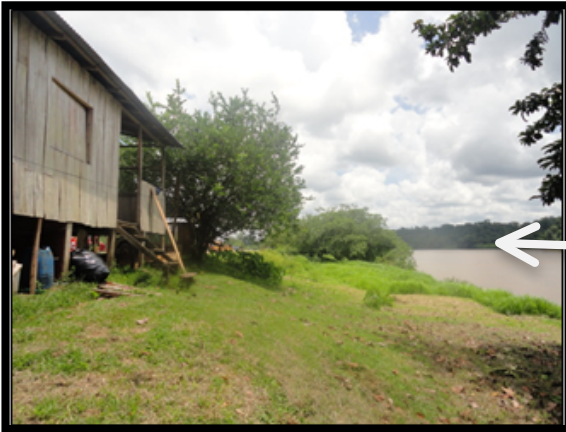
F18. Existen tramos donde el trazo de la trocha pasa muy cerca del margen del río San Juan, deben revisarse dichos tramos
