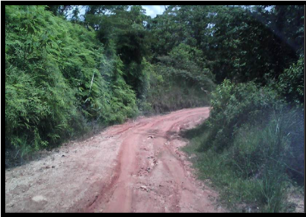
F24. Tramos con surcos y baches y sin drenajes
