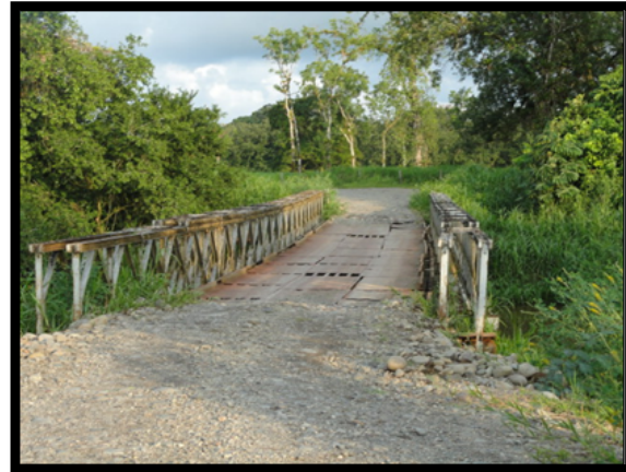
F4. Puente Bailey en estado avanzado de corrosión, piso con láminas sueltas
