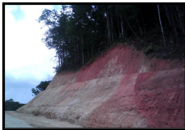
F28. En este sector presentan taludes de grandes dimensiones con pendientes elevados y sin protecciones
