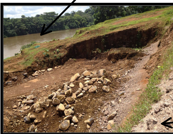
F19. Explotación de materiales, a pocos metros del Río San Juan, se observan agregados muy gruesos y apilamiento de material ya quebrado. Este aparente tajo se ubica entre el río San Juan y la trocha, a pocos metros del río, deben revisarse estas situaciones.
