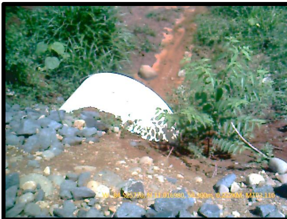
F46. Tubería circular para paso agua pluvial.
