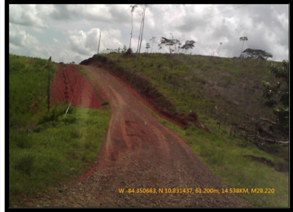
F21. Uno de los sectores donde presentan surcos y baches, además de pendientes longitudinales muy elevadas.
