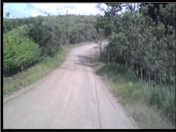
F20. Falta de mantenimiento en los canales de drenaje
