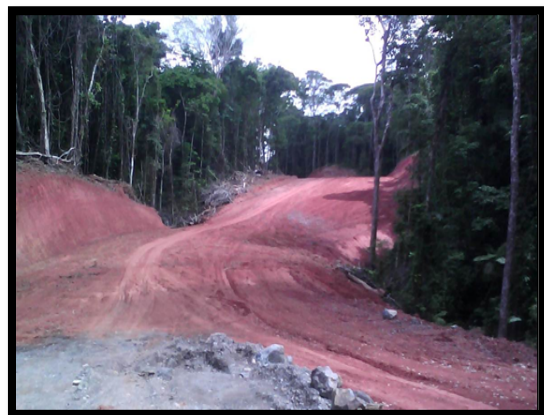
F37. En este punto finaliza el lastreado de este sector, es casi intransitable el camino de tierra, nótese la afectación al bosque.
