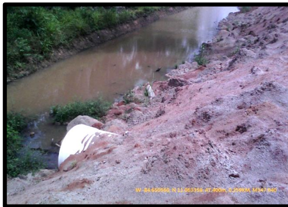
F41. Paso de agua pluvial por tubo circular.
