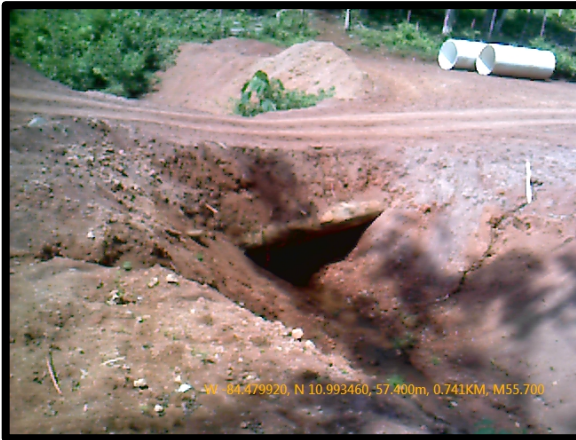
F48. Puente y paso pluvial con troncos de madera.
