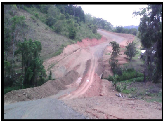
F36. En este sector los trabajos están inconclusos
