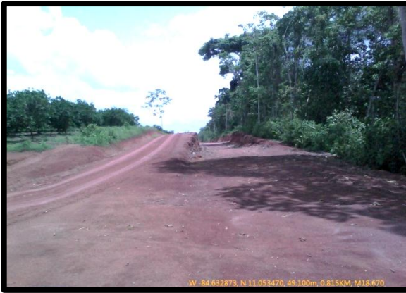
F39. Vista frontal de tramo con desniveles
