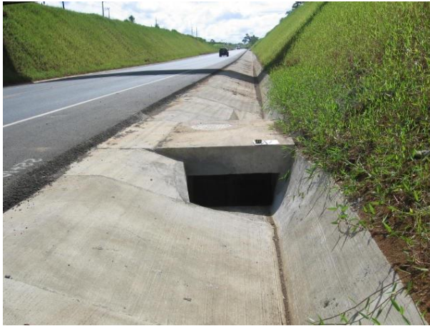
Fotografía 14. Tragante del sector Sur. Estacionamiento 21+900
