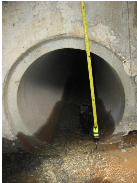
Fotografía 12. Tubería de salida de la caja de registro, sector Norte.
