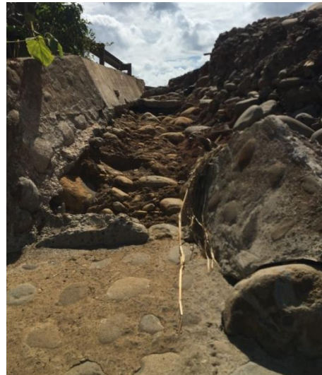
Fotografía 17. Estructura de caída erosionada en el sector Norte del sistema pluvial.
