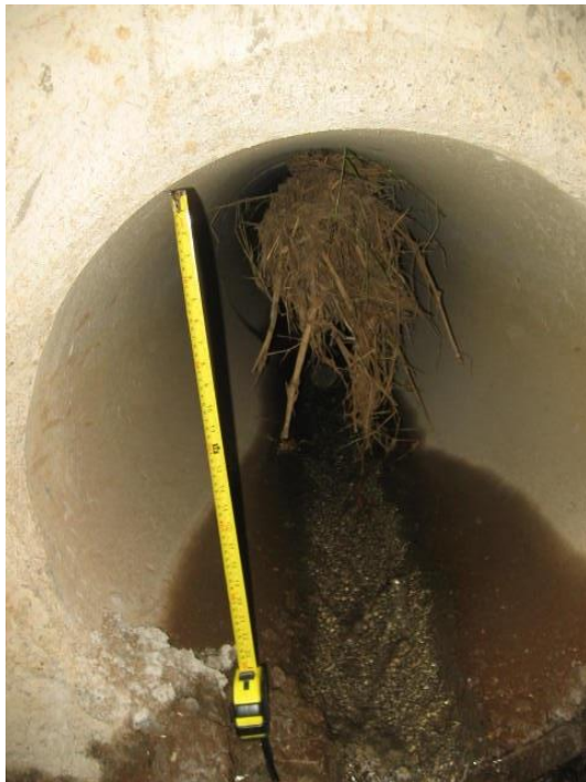
Fotografía 11. Tubería que ingresa a la caja de registro, sector Norte.
