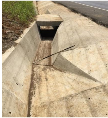
Fotografía 20. Contracción y cambio de pendiente en la aproximación de los tragantes.
