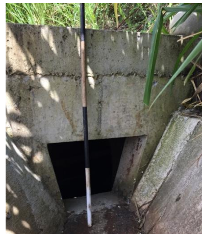
Fotografía 8. Tragante de la caja de registro.
