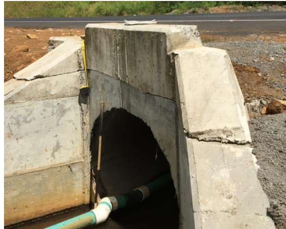
Fotografía 6. Daños en el cabezal de entrada.
