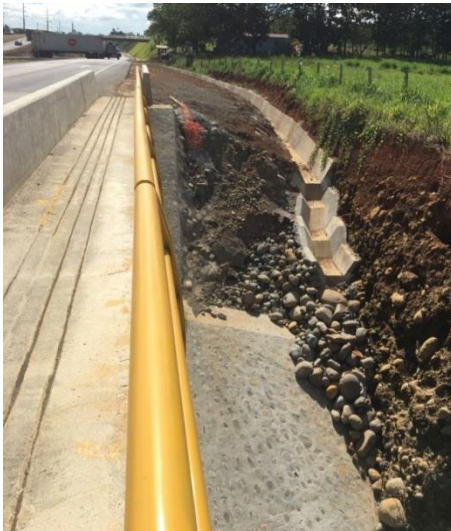
Fotografía 16. Estructura de caída del sistema pluvial ubicada en el sector Sur.
