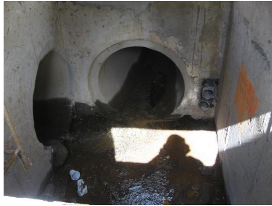
Fotografía 13. Flujo en la caja de registro del sector Norte.
