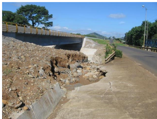
Fotografía 18. Tramo de cuneta destruido por la acción del agua en el sector Norte.
