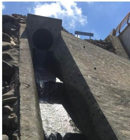
Fotografía 22. Desfogue de la tubería en el río Tres Amigos.
