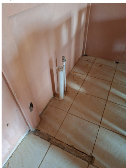
Figura 2.13. Tuberías en desuso
