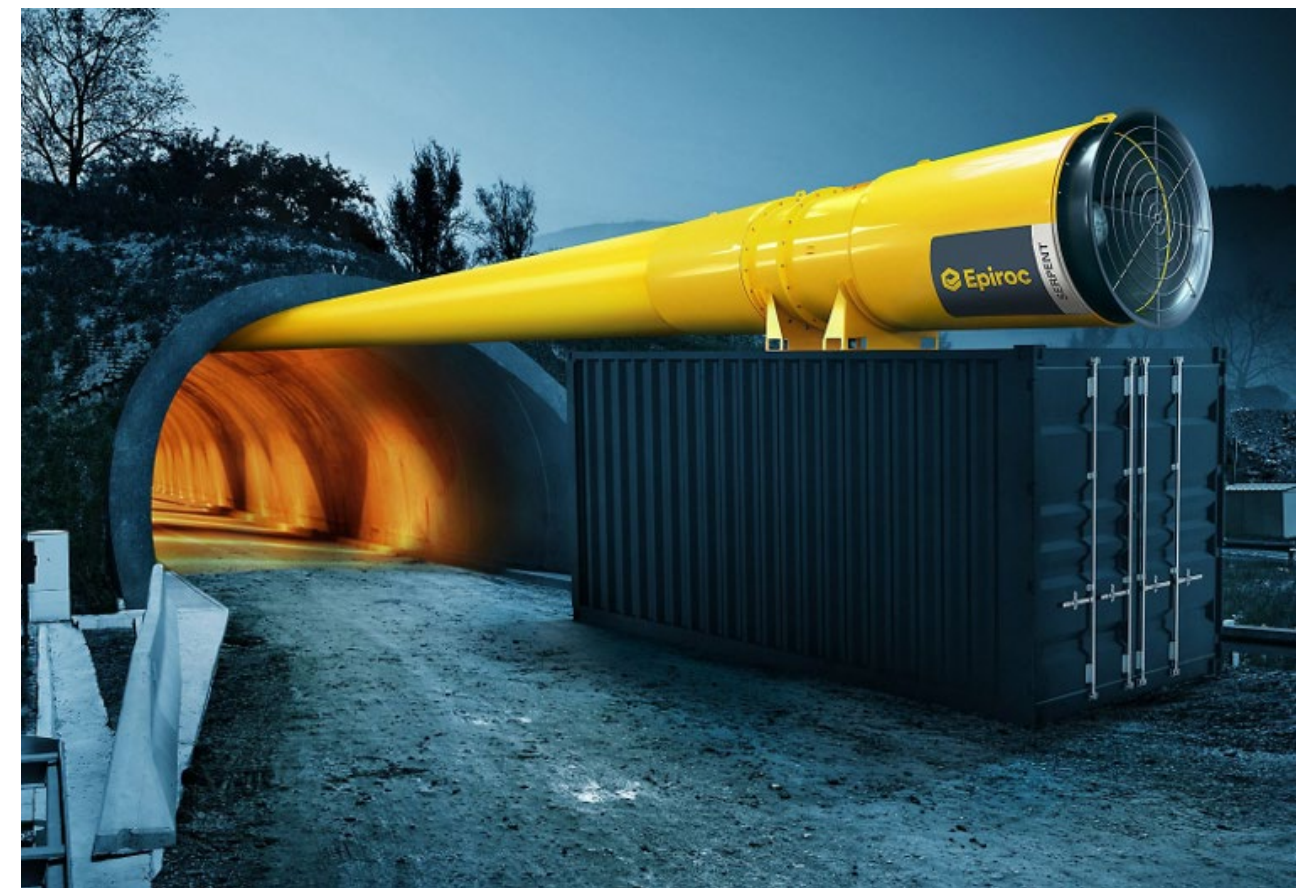
Fotografía 27. Abanico externo y ducto flexible.
