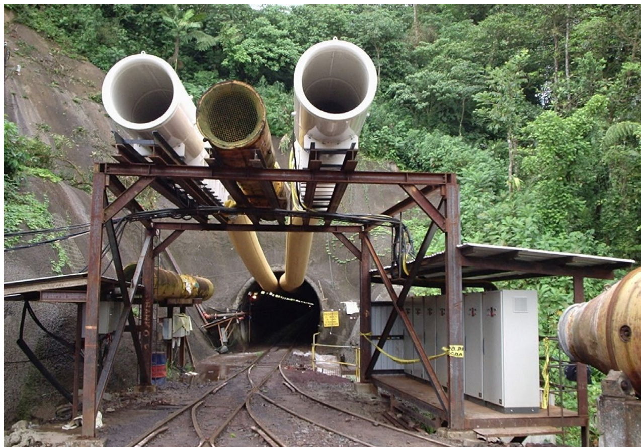
Fotografía 28. Sistema de ventilación en el túnel del proyecto hidroeléctrico Cariblanco
