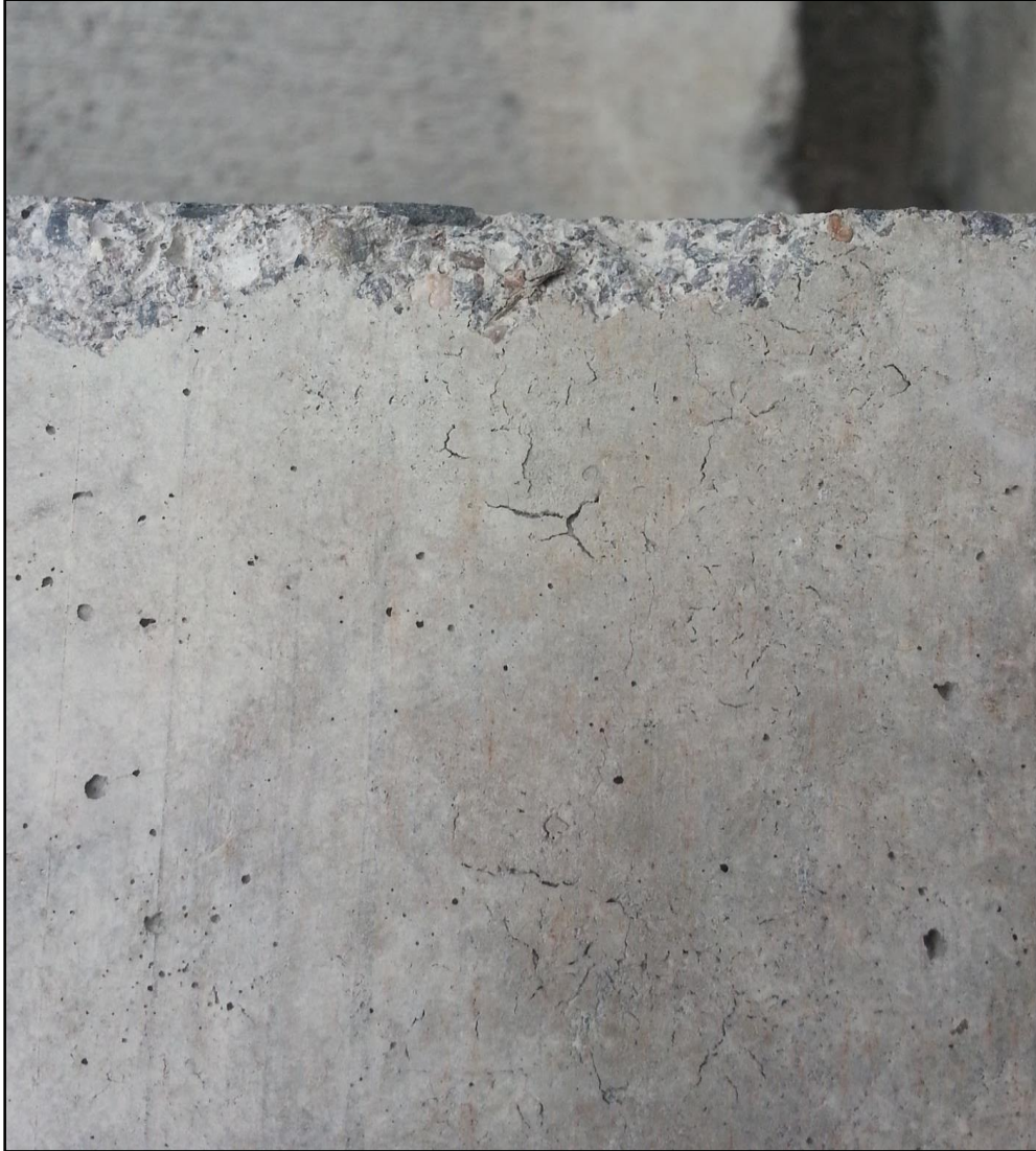
Imagen 55. Formación de astillas y grietas en losas sometidas a radiación durante 2 horas.
