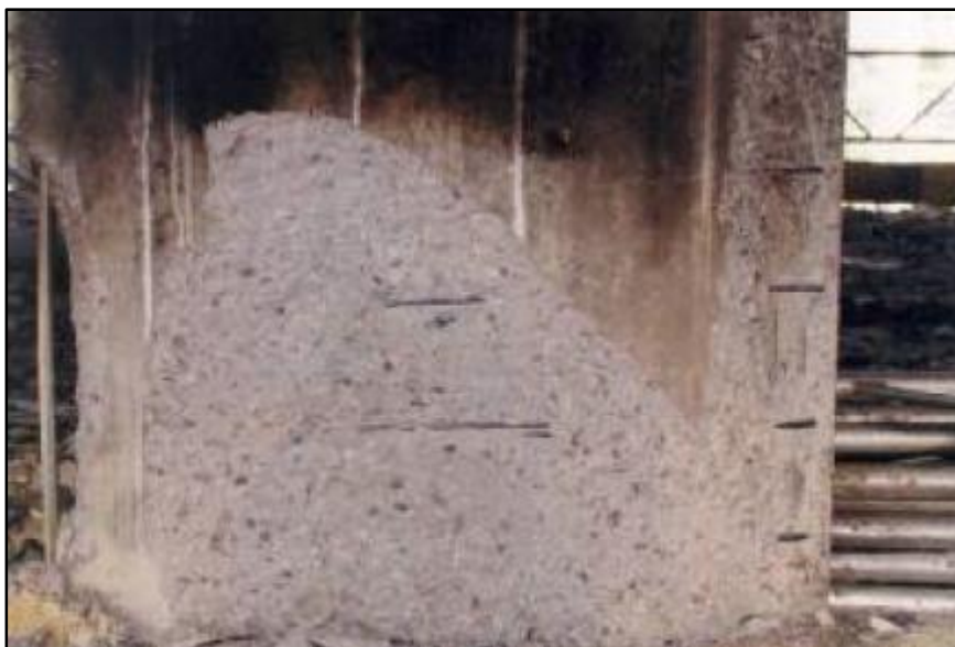
Imagen 6. Desprendimiento de esquinas.
